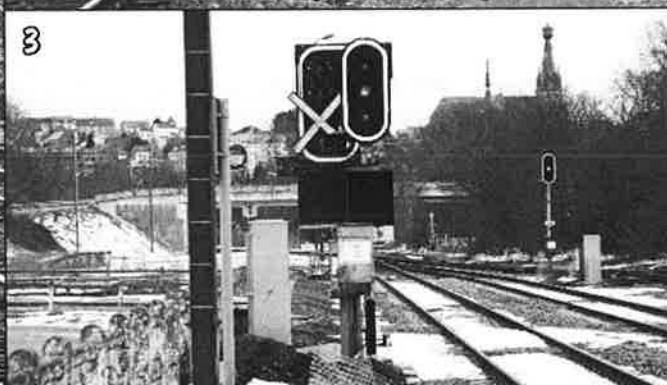
L'ancien signal de sortie de la voie 1, encore en service, avec le nouveau juste derrière qui attend la mise en route de la nouvelle signalisation (Walcourt, 16 mars 2013).
